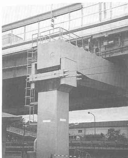
写真-1 梁部変位制限装置
