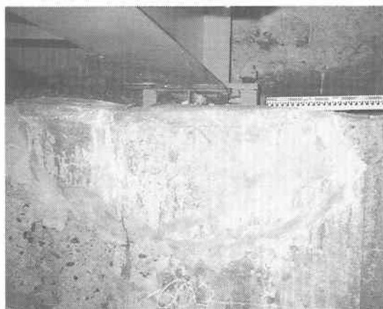
写真-1 支承部のアハットの破損と定着している橋台のコンクリートのめくれ上がり (合成桁道路橋、別海町万年)
