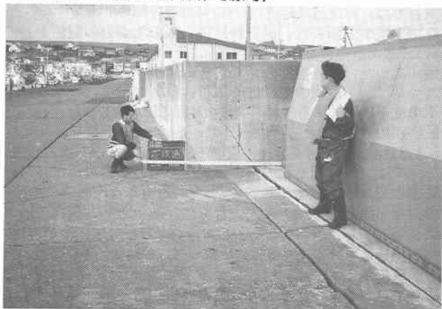
写真-4 岸壁が傾きコンクリート版エプロンが沈下破断(漁港岸壁・エプロン, 歯舞)
