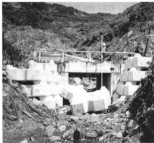
写真10 津波等による高欄と護岸の損傷
