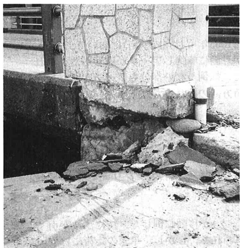
写真8 橋台部コンクリートの破損
