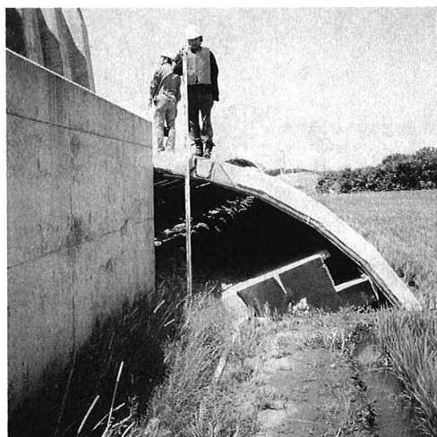
写真6 基礎の転倒によるアーチの倒壊
