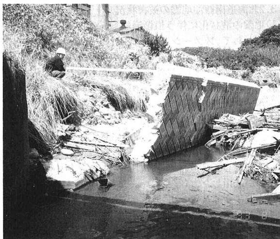
写真9 津波等による道路橋護岸の移動転倒
