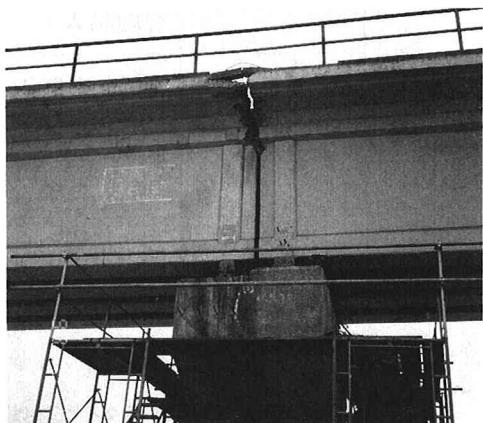
写真4A 沓の破損と桁端部コンクリートの破損
