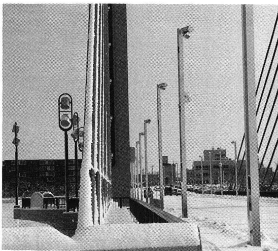
(写真-5) 左岸側から見た灯具群
