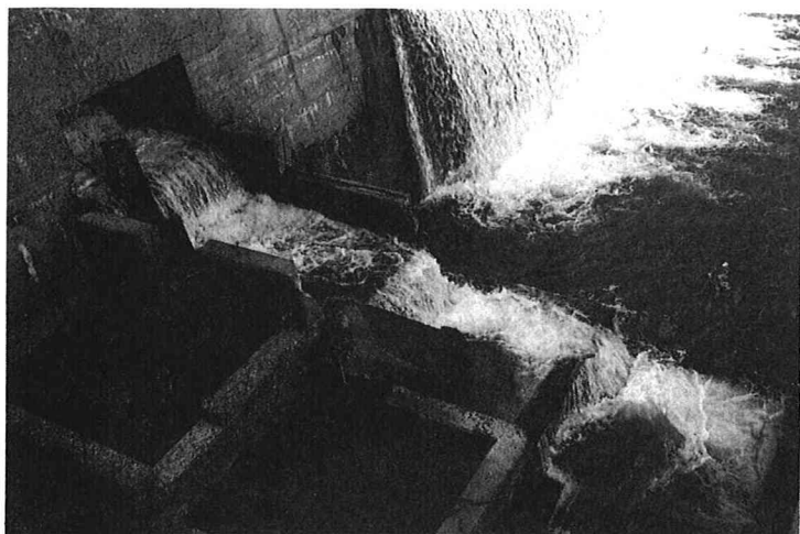
写－３ 魚道の破損の例
