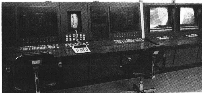
写真-1 藻岩浄水場DDCシステム
