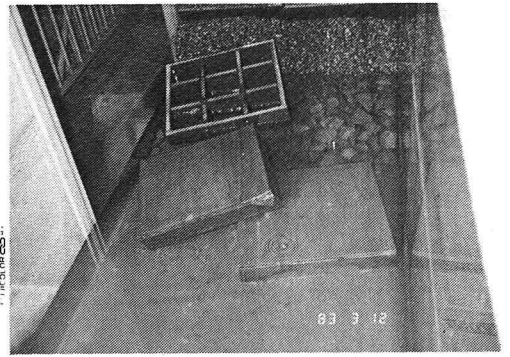
写真-6.6 手前は港内側へ滑り落ちた上部工
