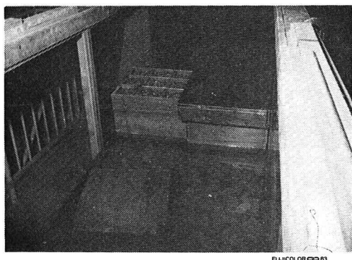
写真-3 H=6.8\text{m} (上部工の滑り落ちた状態を港内側より眺める)
