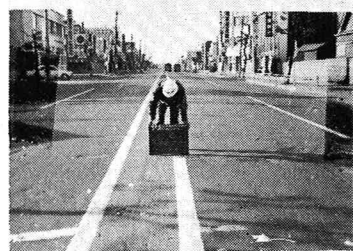
写真-1 補修前の路面状況
