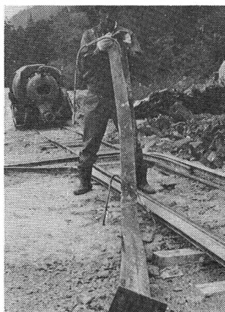
写真－10 同上H型支保工の屈曲状況
