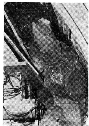
写真一8 グリッパー上部崩落状況
