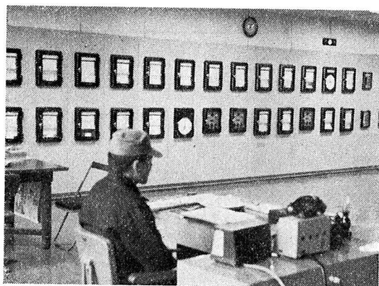
写真一五 藻岩第2浄水場 管理室(自計装パネル) (第1期拡張)
