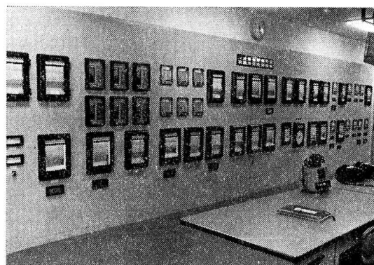
写真一六 藻岩第2浄水場 管理室(自計装パネル) (第2期拡張改造)
