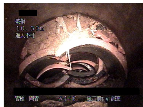
図-1 伏び管の破損例
