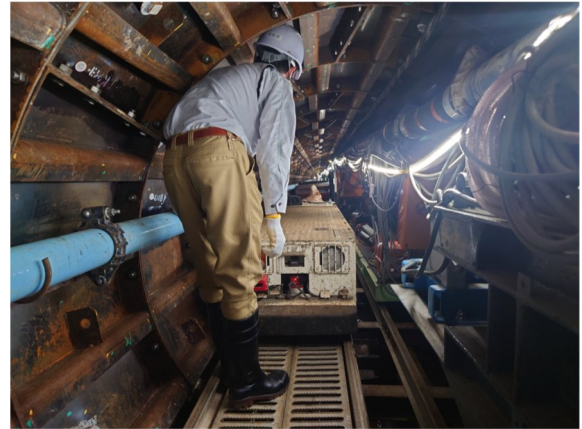
写真4 坑内作業員の退避場所が確保できない状況
