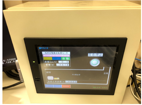
写真-2 中央制御室監視モニタ画面
