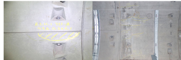
c) セグメント継手部のうき d) 縦断方向のひび割れ
