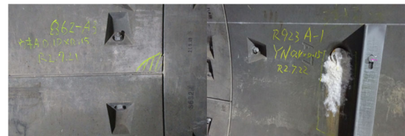
a) 隅角部のうき b) 注入孔からの漏水（遊離石灰）
