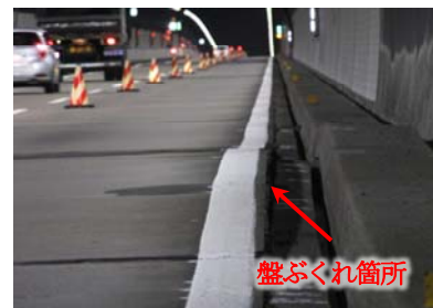
写真-1 盤ぶくれ発生状況
