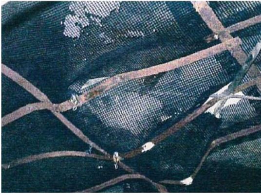
図-5 クラウン部周辺の第2次変状の発生状況
