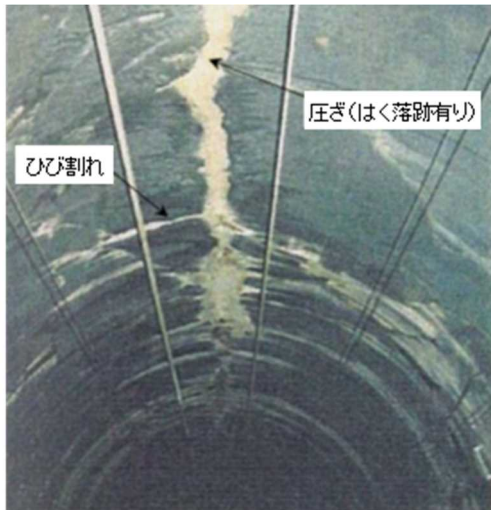
図-1 アーチ部の変状
