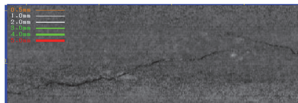
(2) クラックスケールによるひび割れ幅の計測例
