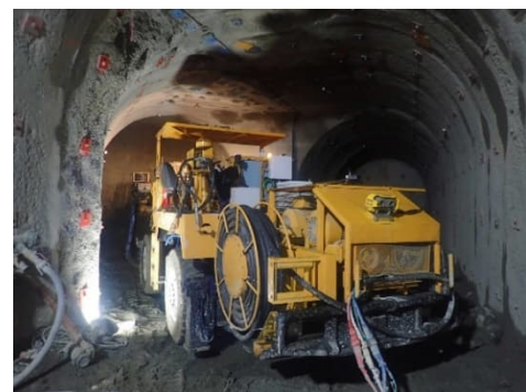
※施工時期・地域性を踏まえた施工機械(ドリルジャンボ)
