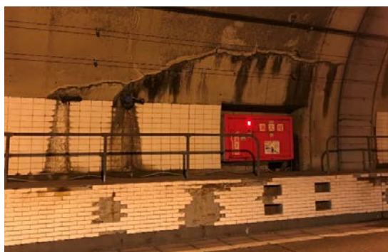
写真-2 箱抜き周辺の損傷状況
