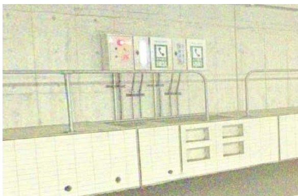
写真-7 壁掛け非常電話
