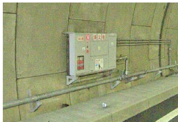
写真-8 薄型消火栓
