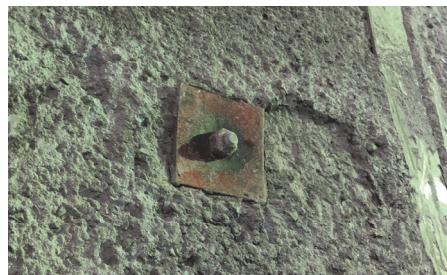
写真-3 ロックボルトプレートの変形
