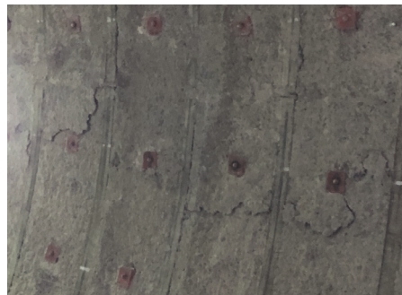
写真-2 吹付けコンクリートの圧ざ
