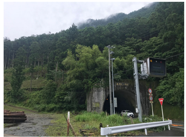
図-2 被災後のトンネル坑口部状況
