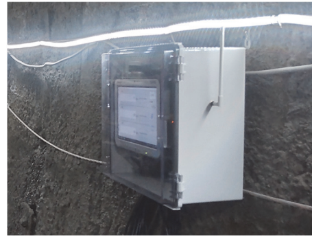
図-7 通信親機の外観
