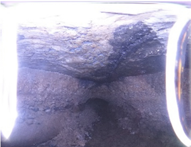
写真-1 トンネル路面下の空洞状況
