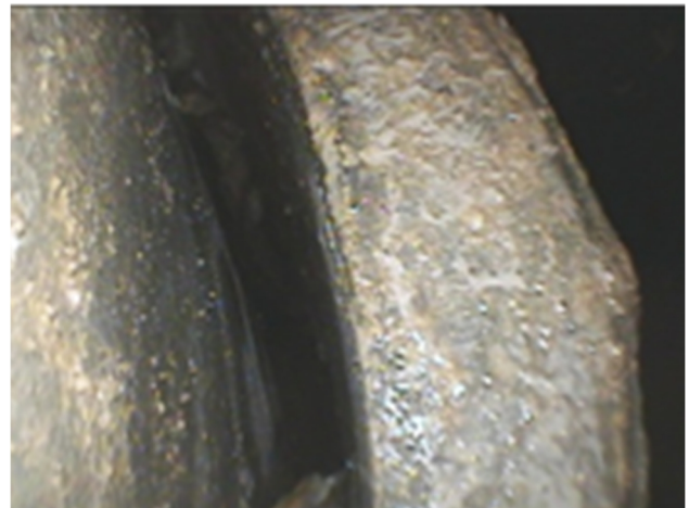
写真-2 中央排水管のジョイント開口部
