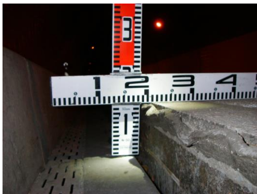
写真-1 路面の変状発生状況
