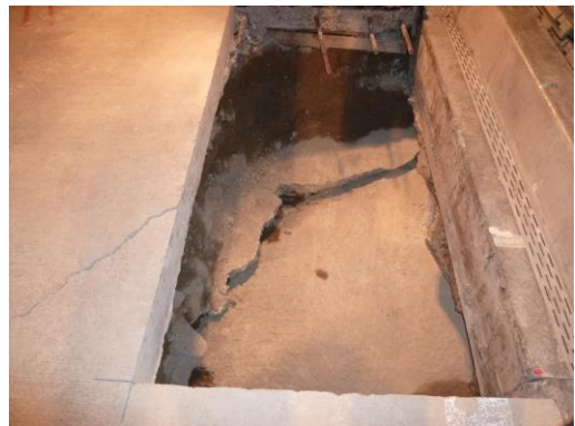
写真-2 インバートの変状発生状況
