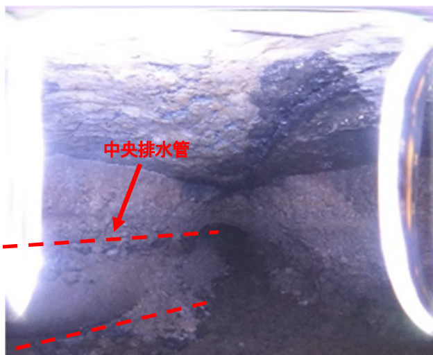
写真-1 トンネル路面下の空洞状況
