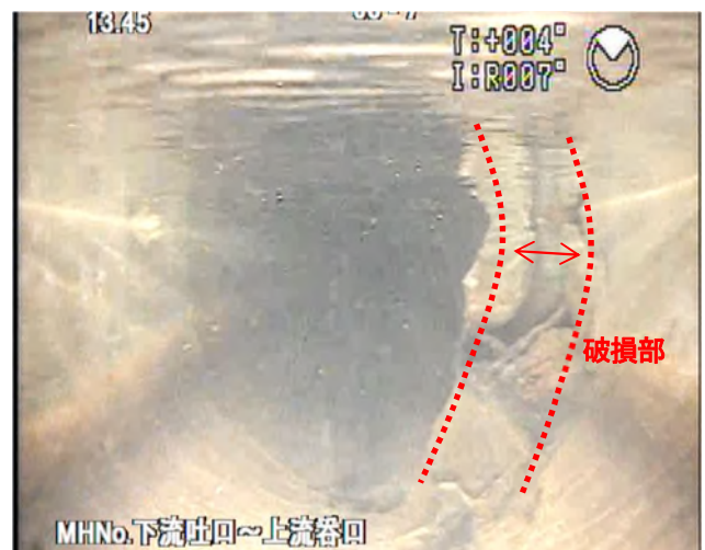
写真-5 中央排水管内部の破損部
