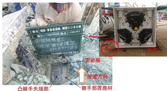
写真-3 継手先端部と泥岩層との接触状況
