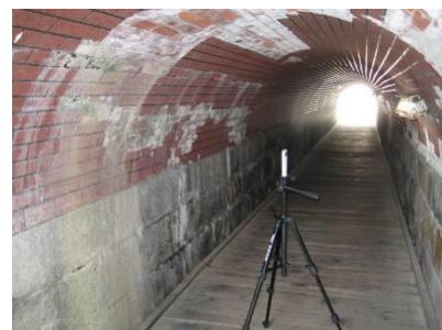
図-2 レンガトンネル（西宮市）内部の劣化状況
