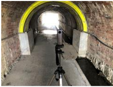
図-3 レンガトンネル（高槻市）内部の劣化状況
