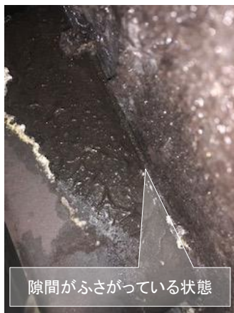
図-25 ボックス上部に蓄積した析出物
