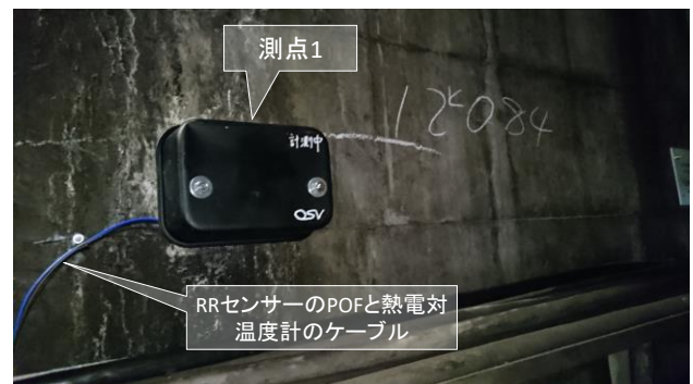
図-12 RR センサー設置の外観
