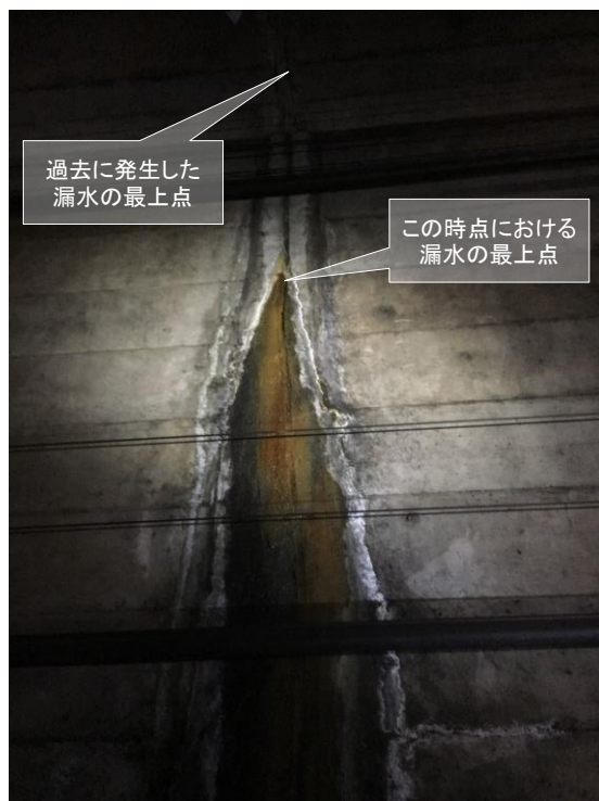
図-1 漏水箇所が上下に変動した例
