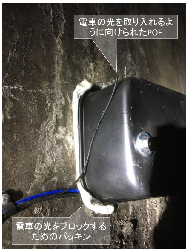
図-17 モニタリング様式②のセットが完了した様子
