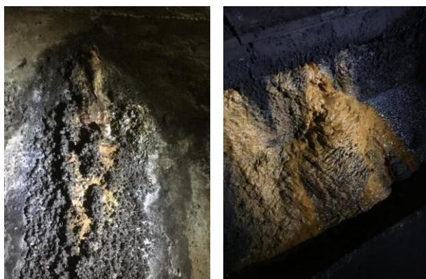
図-2 漏水に伴う析出物の蓄積
