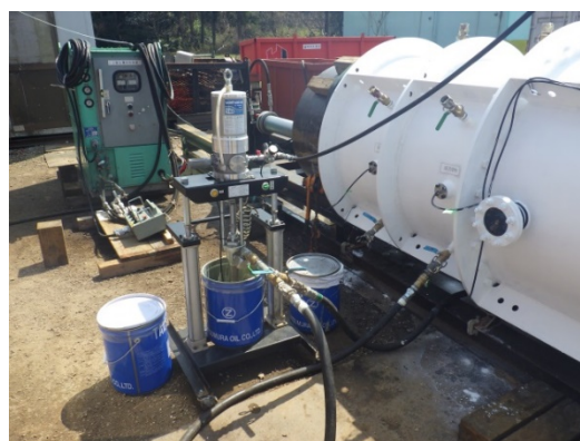
写真-2 グリースポンプ
