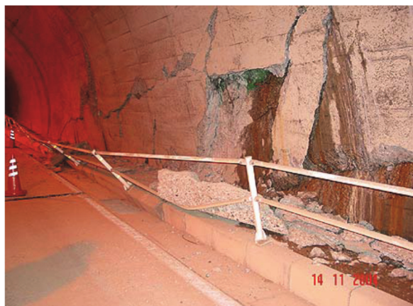
図-6 木沢トンネル被害状況 9)
