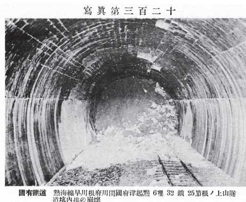
図-2 熱海線早川―根府川間の根ノ上山トンネル坑内の崩落 4)
