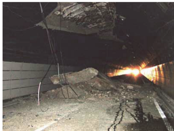
図-5 国道17号川口町和南津トンネルコンクリートの剥落 9)
