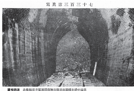
図-3 北條線（現在の内房線）岩井―富浦間南無谷トンネル坑内崩落 4)
