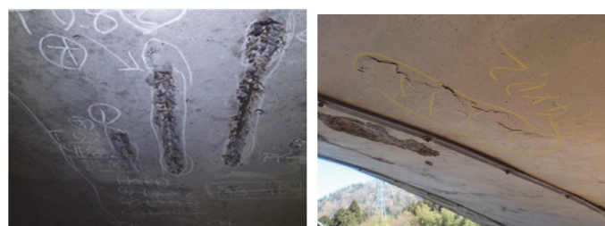
図-5 変状発生状況
