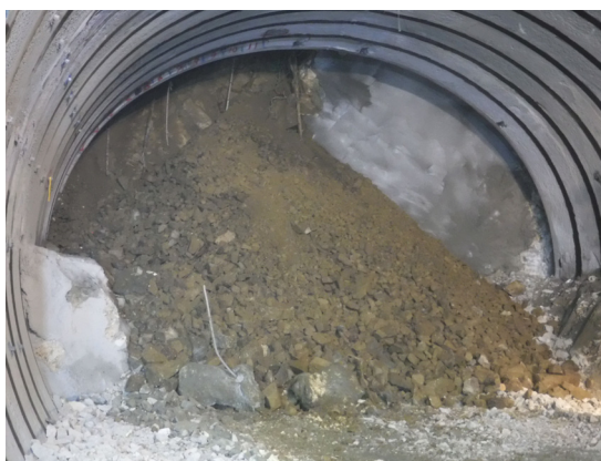
写真-5 地山流出状況（支保 No. 73 : TD73m）
