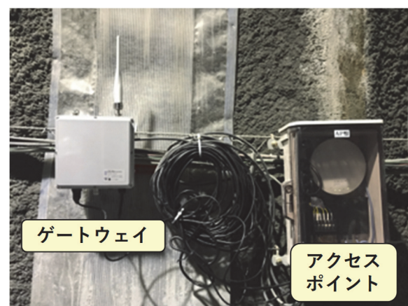
図-9 ゲートウェイの坑内設置状況
