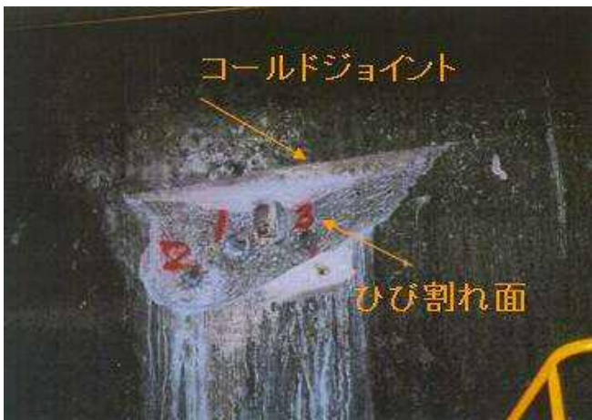
写真-7 コールドジョイントに起因するはく落
