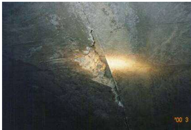
写真4 横断目地のひび割れ
