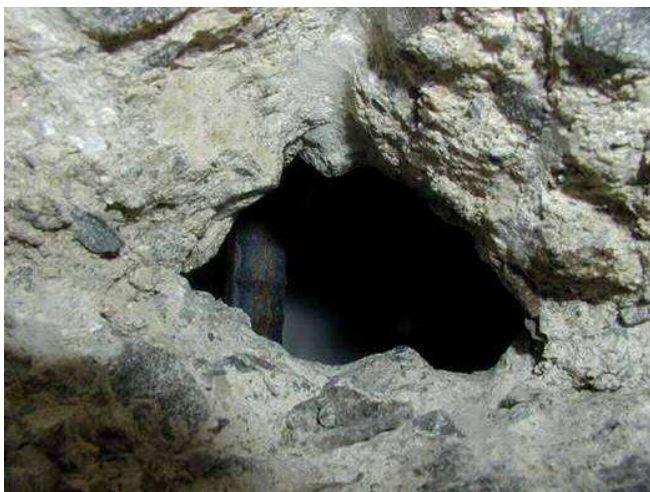
写真-8 覆工背面の空洞
