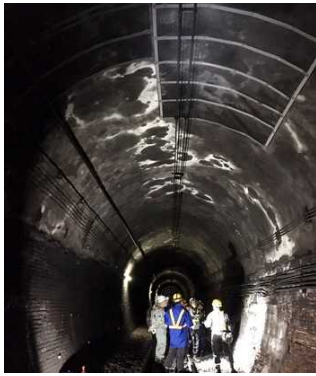
図-1 変状箇所概况
