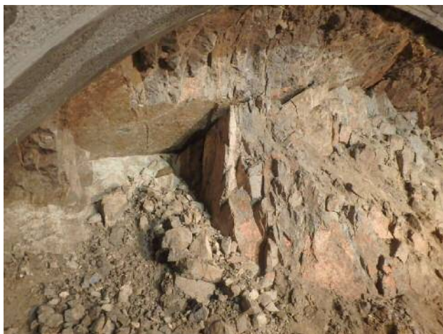
写真-4 崩落時切羽状況
