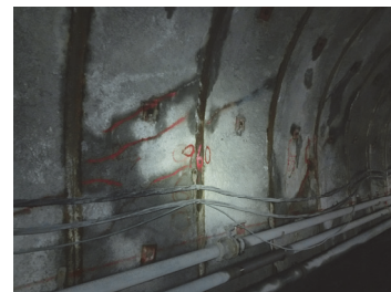
写真-1 吹付けコンクリートのクラック
