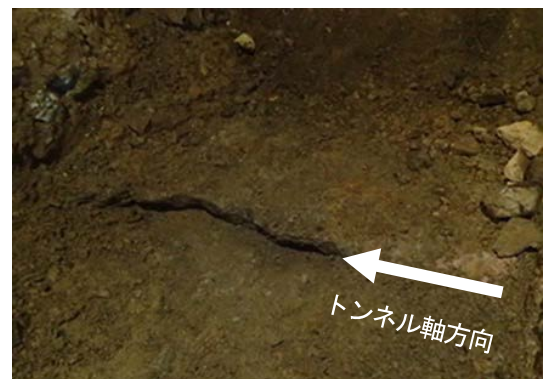
写真-3 インバート吹付けのクラック
