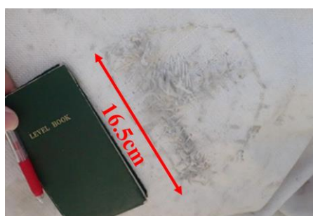
図-6 縫合による防爆シートの補修の跡
