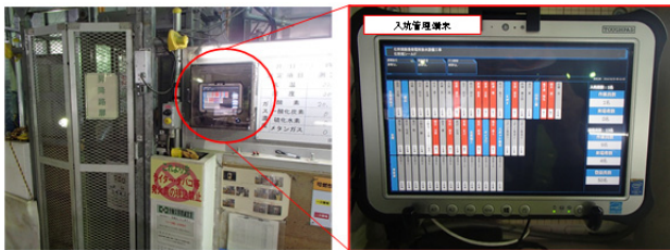
写真-2 立坑上に設置した自動入坑管理端末
