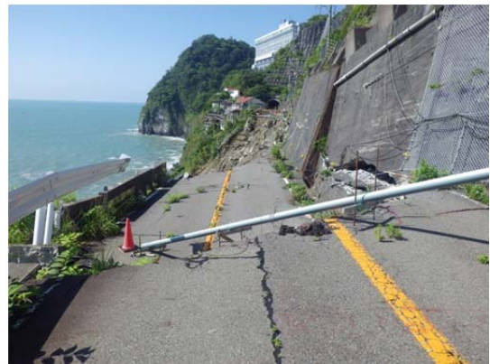
写真-1 現道崩落状況
