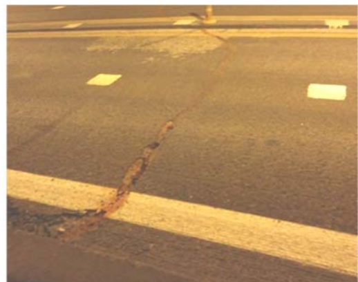
写真-1 盤膨れで路面に発生したき裂 1)
