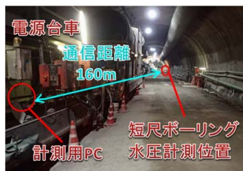
写真-9 モニタリングの通信状況
