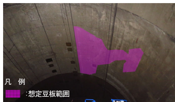
図-7 覆工内部豆板の注入補修箇所
