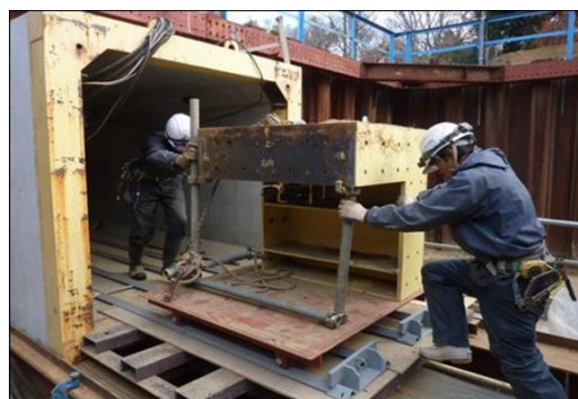
写真-4 分割した刃口の引戻し
