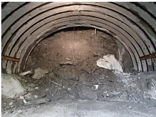
写真-2 切羽崩落状況(支保 NO. 26)
