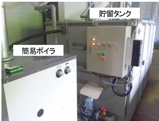
写真-2 温水製造設備
