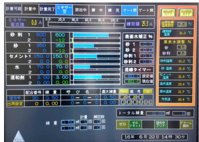
写真-6 制御盤の操作パネル画面
