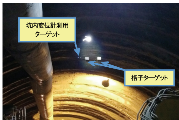
図-7 天端に設置したターゲット
