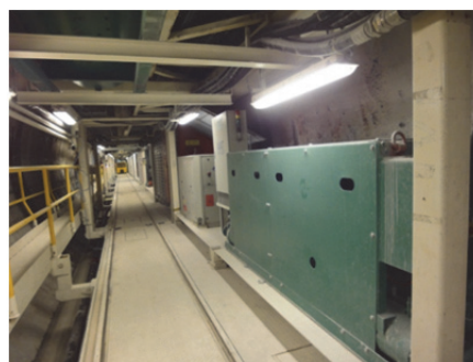
写真-1 TBM水冷式冷却設備
