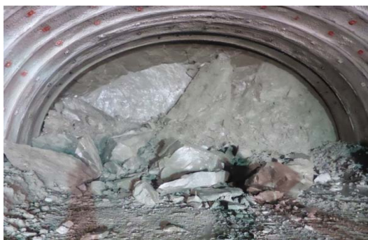
写真-1 切羽崩落状況 (測点 P704)
